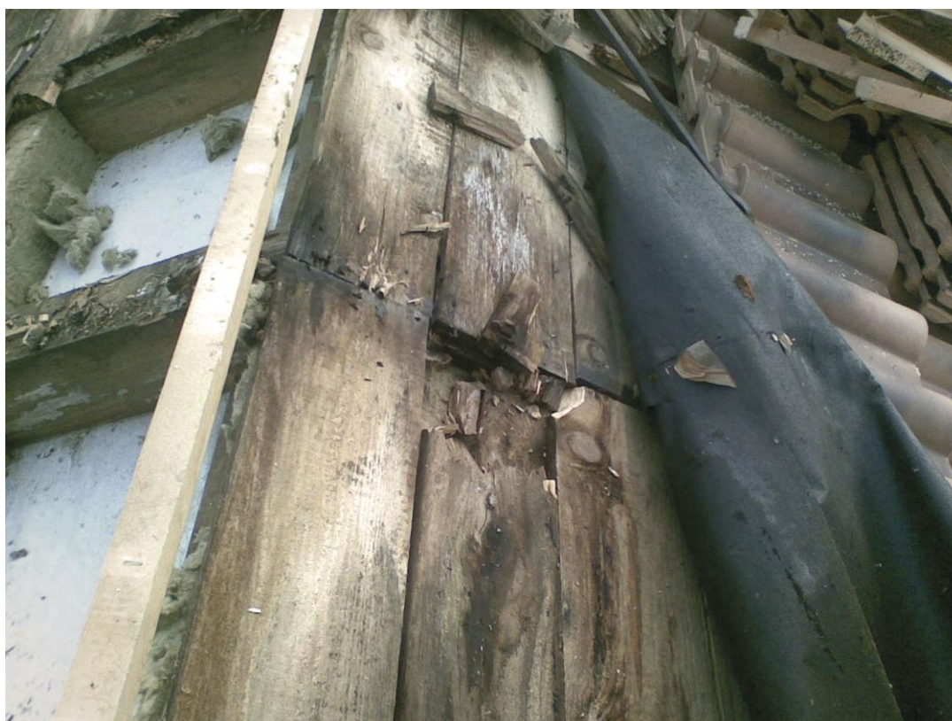
Figura 6 Tetto in legno con degrado da condensazione interstiziale. La condensa formatasi sotto la membrana impermeabile ha portato all'ammaloramento della struttura in legno e alla perdita di capacità coibente dello strato di materiale isolante.
